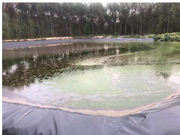
养殖废水无害化处理（储粪池生物氧化池）
