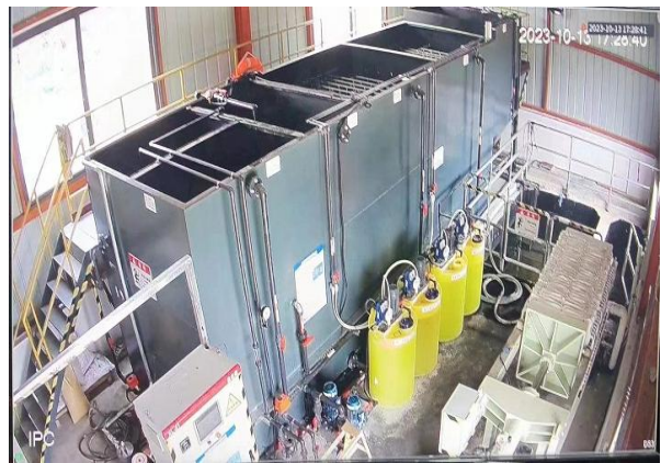
生产废水污水处理站
