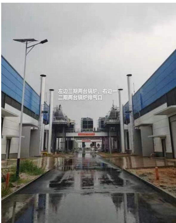
锅炉废气排气筒
