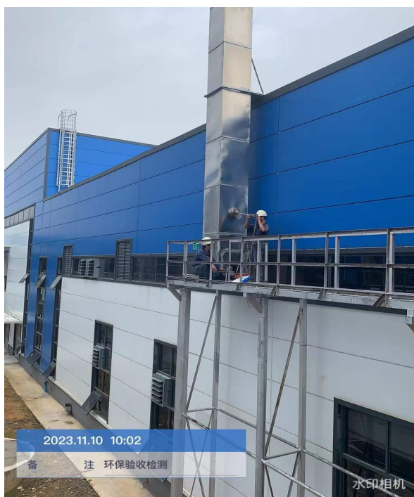
涂布废气排气筒
