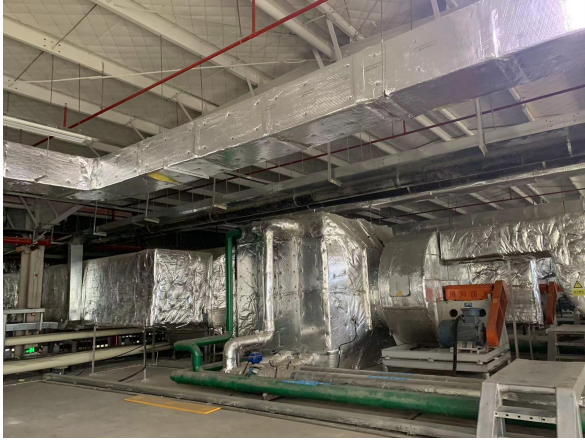
涂布废气处理设施
