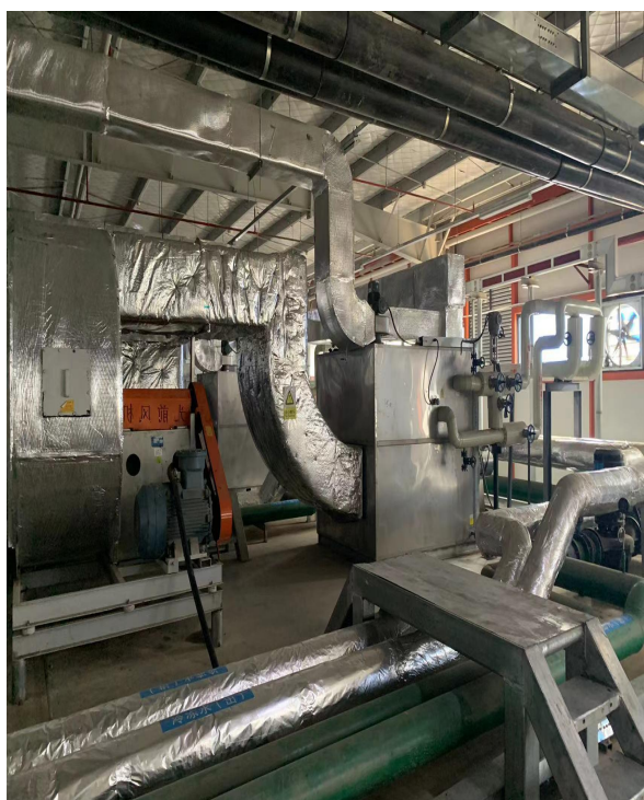
涂布废气处理设施
