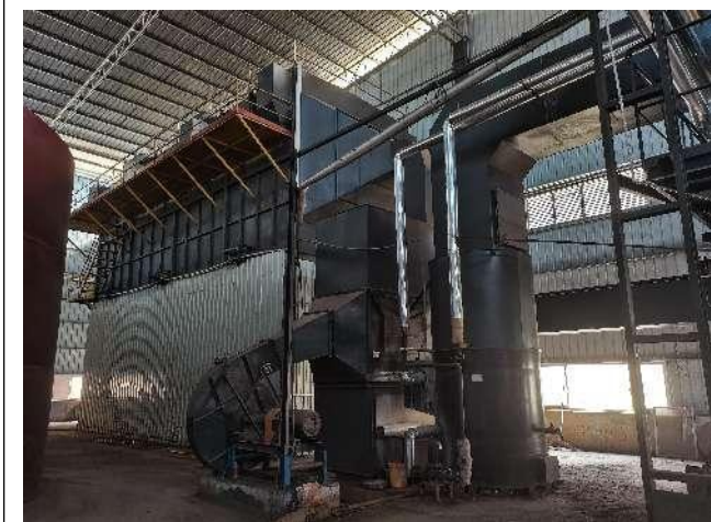
锅炉废气处理设施静电除尘器
