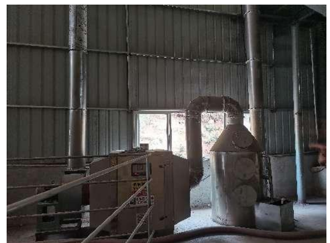
制胶工序废气处理设施
