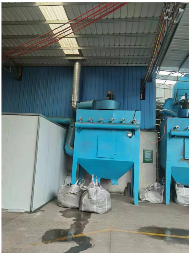
电炉熔炼废气布袋除尘器
