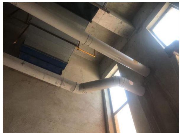
排气筒采样口
