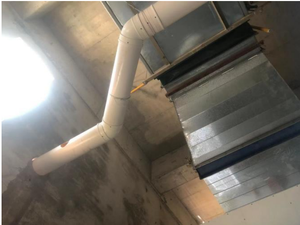
排气筒采样口
