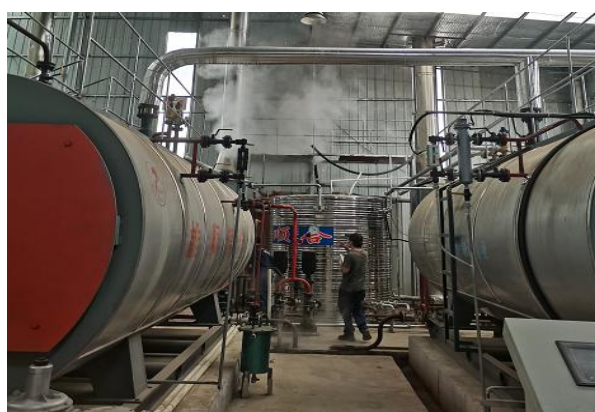
蒸汽发生器（燃气锅炉）
