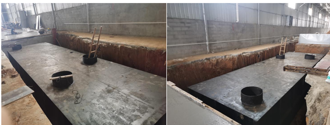
废水处理设施（隔油池）
