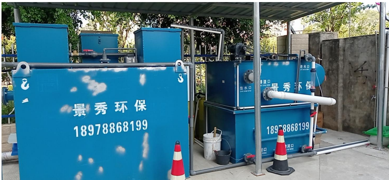
废水处理设备
