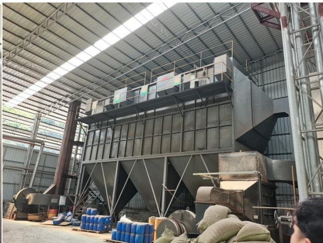
(锅炉) 静电除尘器
