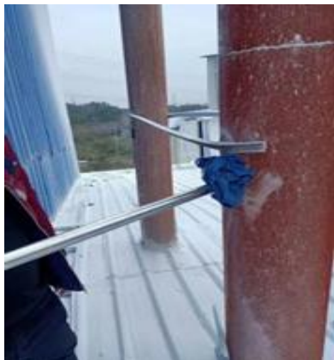
消化工序排气筒
