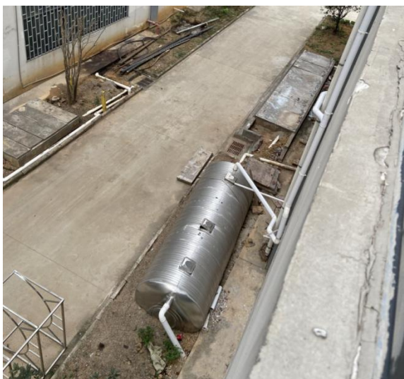
废水总排口监测点
