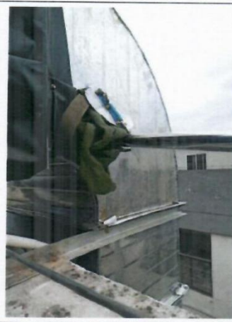
废气、油烟排放口
