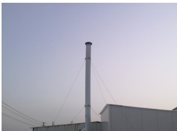
污水处理站废气排气筒
