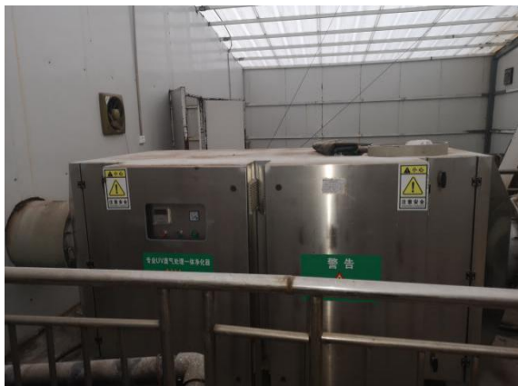
污水处理站废气处理装置
