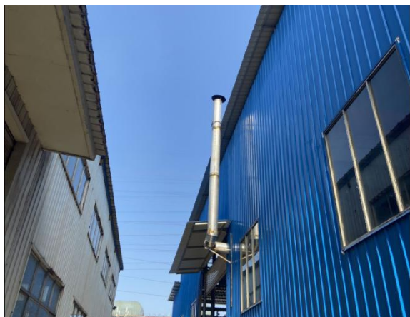
电炉废气排气筒
