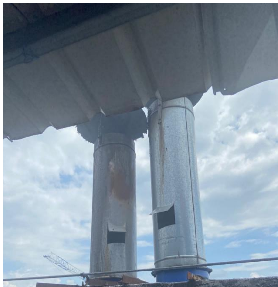
两个 15m 排气筒
