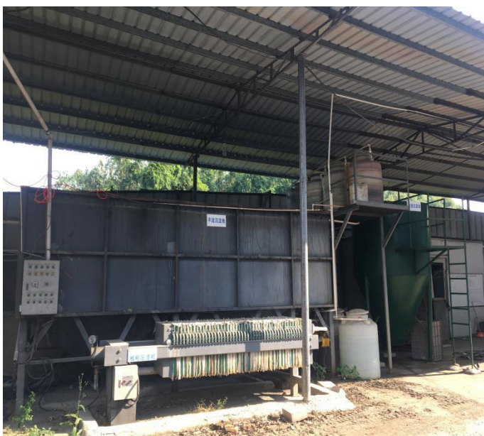
污水处理站压滤机
