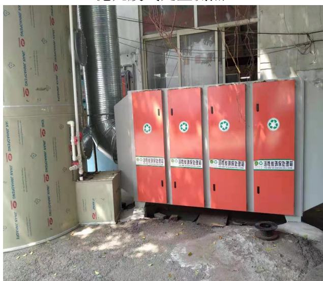
硫化废气处理设施
