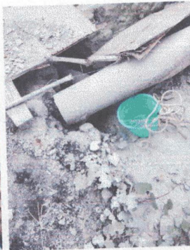
化粪池出水口
