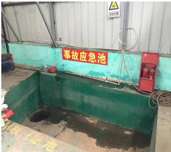
项目废水应急池
